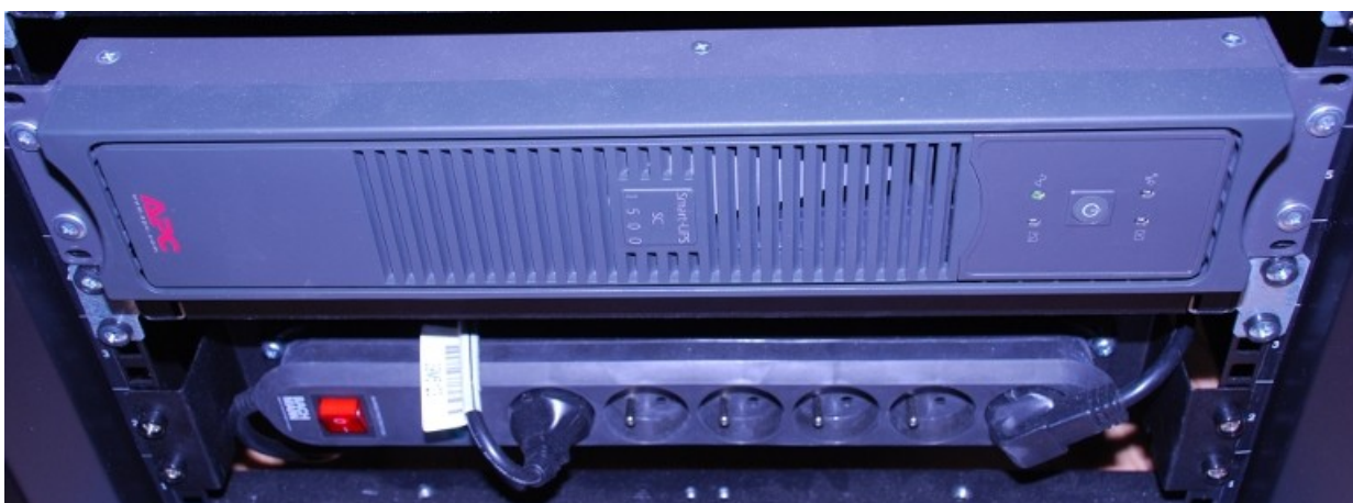
Obrázek 7 - Serverový rack v technické místnosti – UPS APC Smart 1500VA
